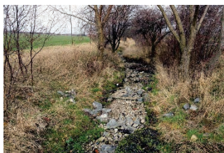
Austrocknung des Urbachs unterhalb d. Ortslage (03/2016)
