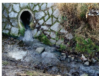
Einleitung von Abwasser in den Urbach (01/2016)
